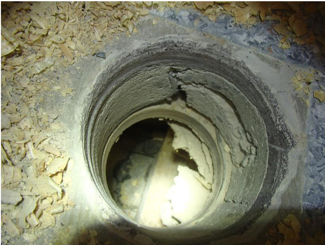
Kuva 8. Rakenneavaus, RAKL2, ruokalan välipohjarakenteeseen yläkautta kuvattuna.
