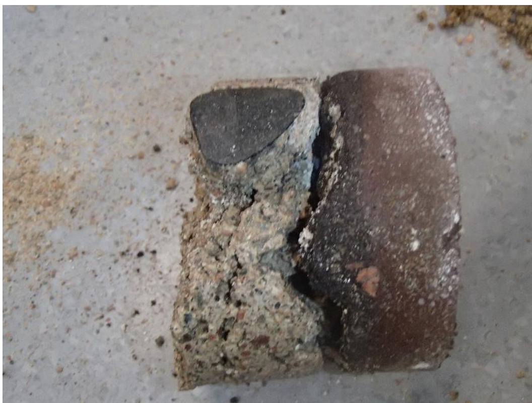
Kuva 12. Rakenneavaus, RAKL3, vanhan musiikkiluokan alapohjarakenteeseen. Pintamateriaalien alla on tiililaatta ja vanha harva betonivalu.
